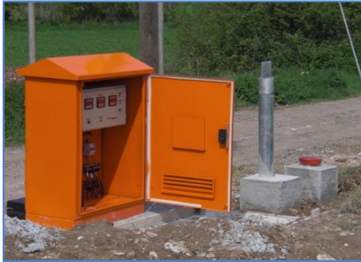
Resim 13. Hava Soğutmalı T/R Üniteleri
